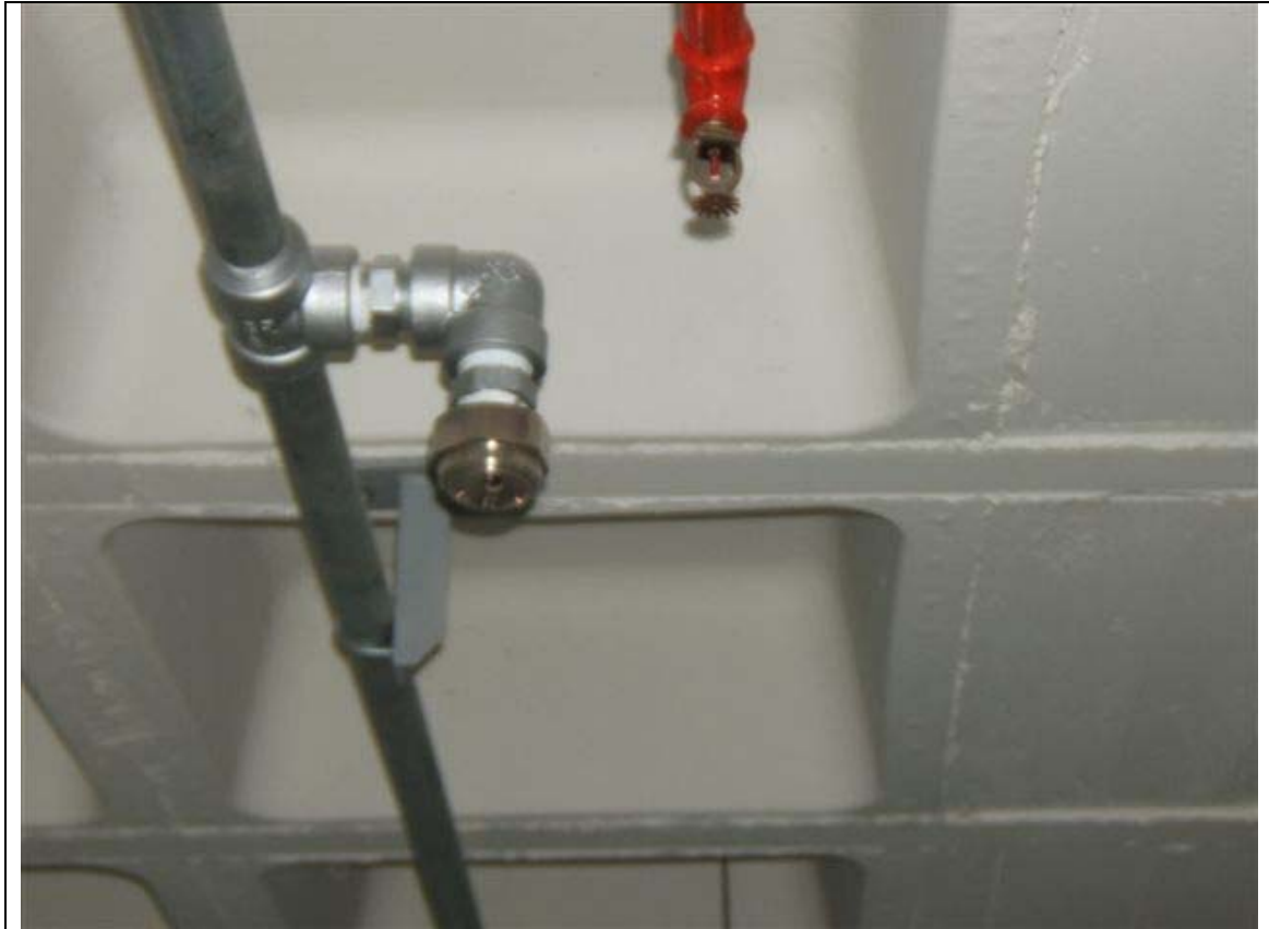
Rociadores de Gas y agua-Bombonas de Gas FM200
